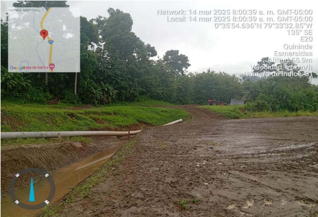
Oleoducto transecuatoriano, que cedió por el deslizamiento de tierra en el sector El Vergel, Recinto el Mirador.
